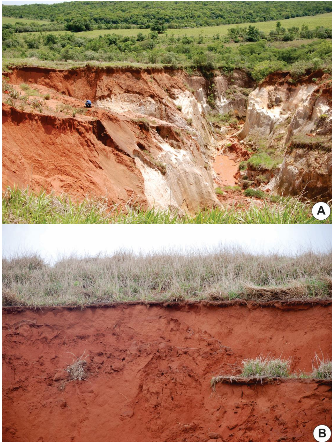
Figura 1. Processos erosivos encontrados ao entorno da mata de galeria da Fazenda Itapoty, Amambai, MS, Brasil, 2013: A: Voçoroca próxima à mata de galeria; B: Pastagens cedendo à fragilidade do solo.
